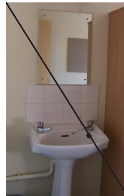
Плохо Раковина с пьедесталом. Фартук из плитки
