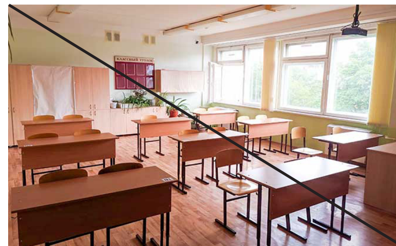
Плохо Линолеум под дерево
